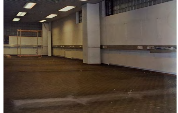
Kuva 68. Kuvassa huonokuntoinen kirjaston alkuperäinen koolattiamatto. Kuva vuodelta 1993.
