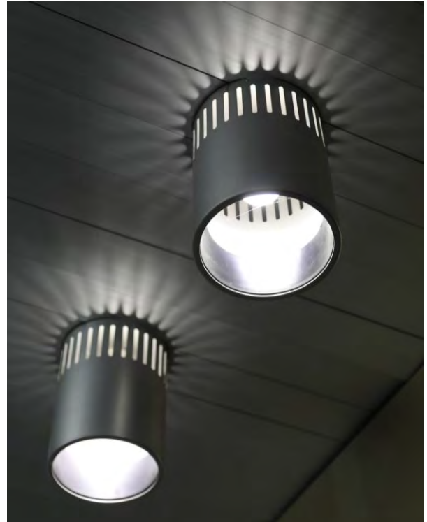
Kuva 126. Kellarikerroksen alkuperäisiä valaisimia.
